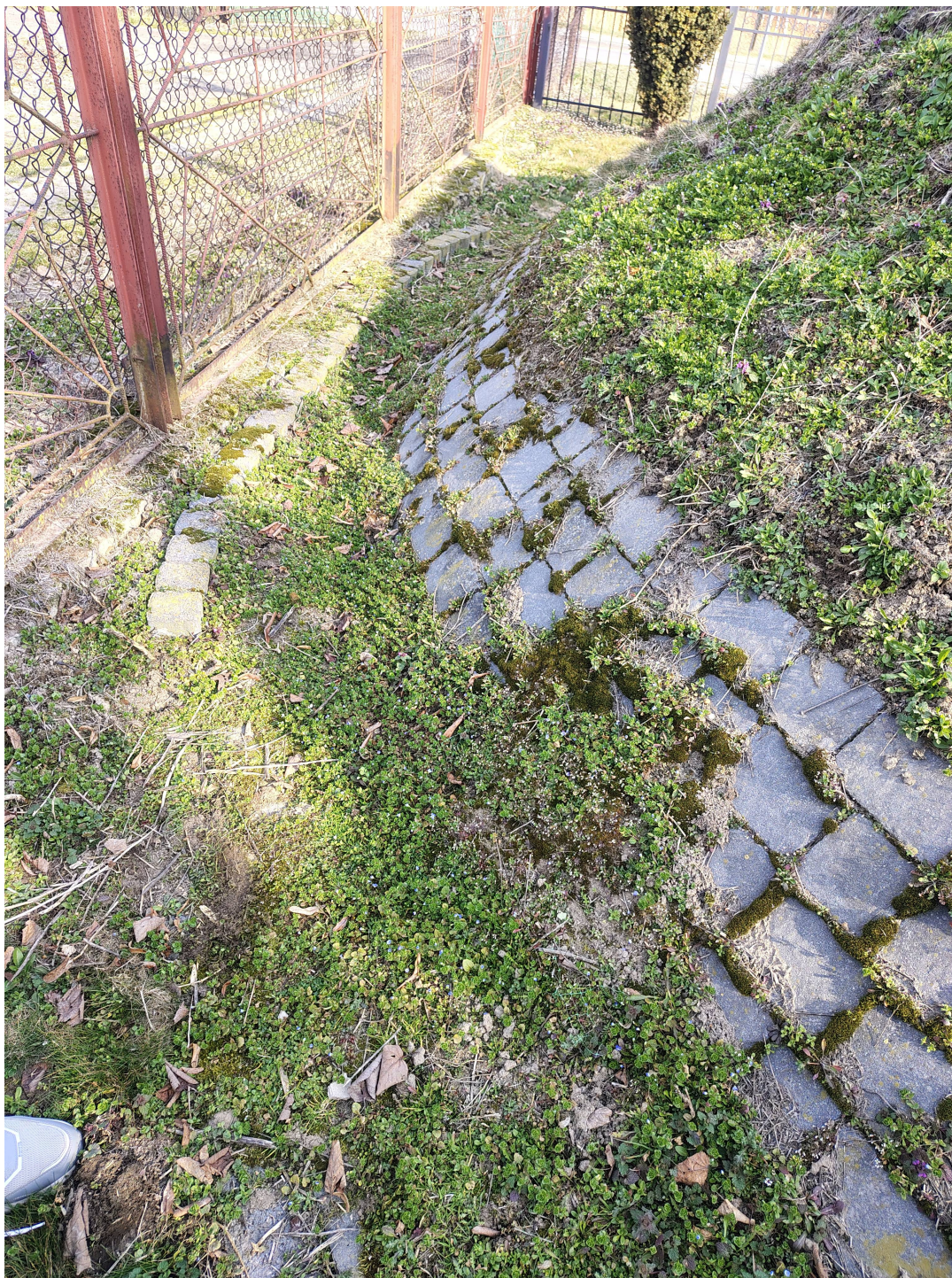
fot.2. uszkodzenia opaski i alejki wokół pomnika
